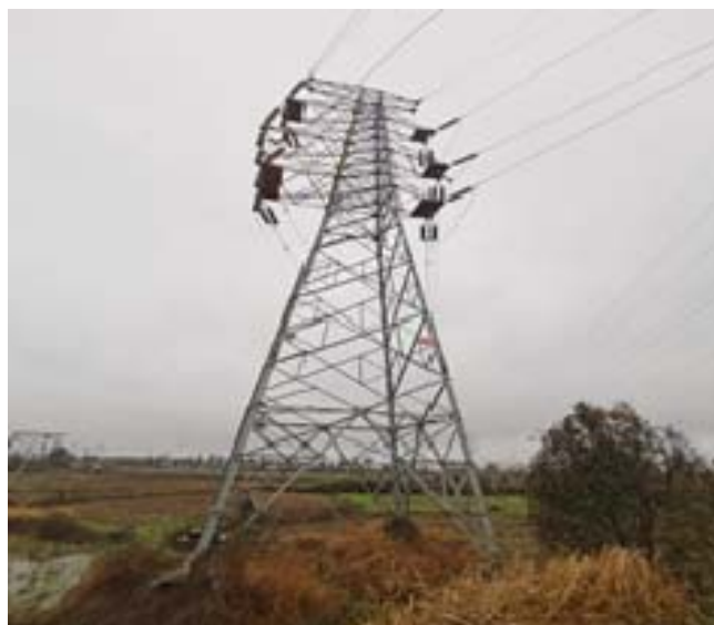
图 2.7 110kV 阳山线 1#现状照片
